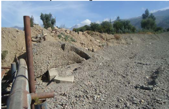
Fig.Nº 5. Deslizamiento y vuelco de gaviones sector tuberías SEMAPA
