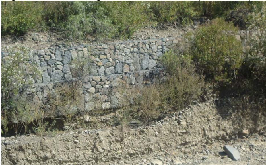
Fig. N° 7. Defensivos de gavión en el Chutakahua a punto de colapsar
